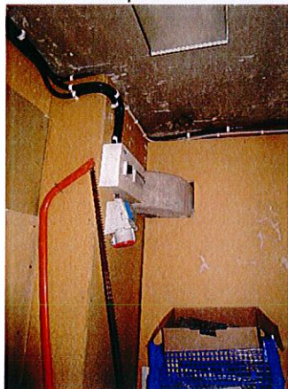
Delvis nyare el, vent.kanal av asbest
