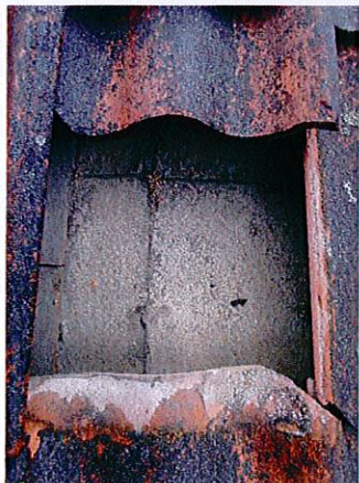
Äldre spröd papp under takpannor
