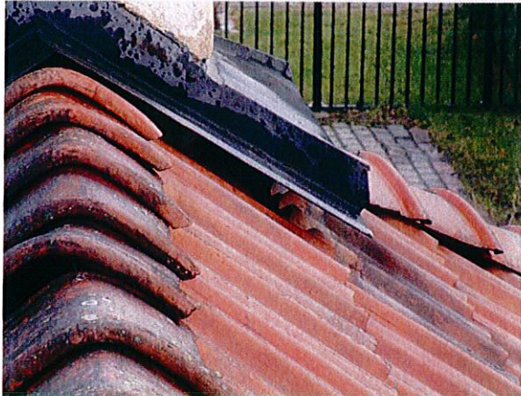
Otätt runt skorstenar
