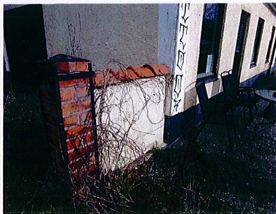
Mur med skador
