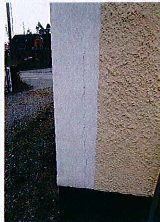
Sprickor på fasad
