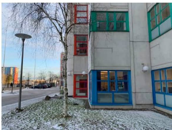
Ovan: Huvudentrén med karaktäristiska kulörta entrépartier och plåtarbeten. Nedan: Karaktäristiskt fasadparti med varierande djup som bidrar till byggnadens volymhantering.
