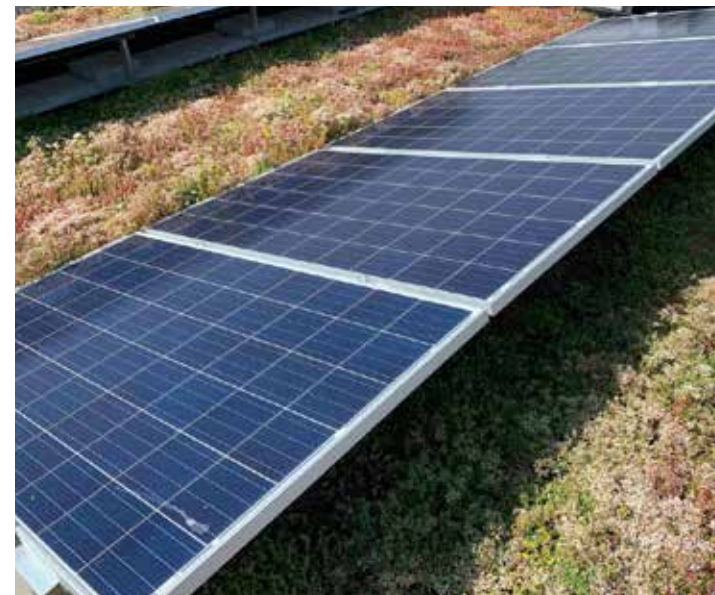
Bild: Solceller tillsammans med sedumtak. Foto sopraema.se
