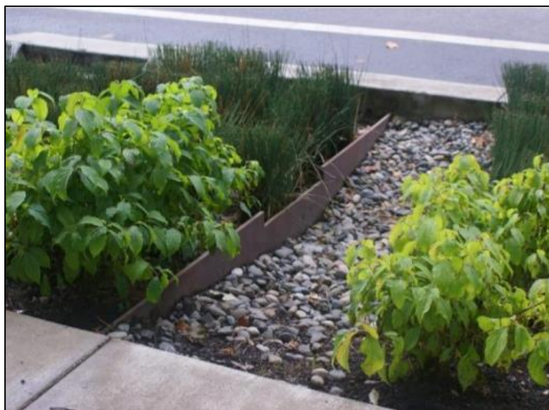
Figur 10. Exempel mindre dämmen i regnbädd
