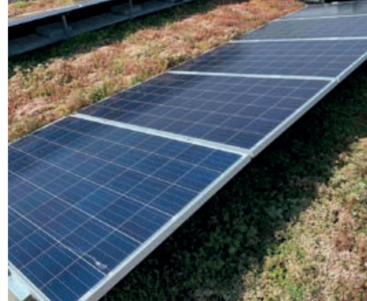
Bild: Solceller tillsammans med sedumtak. Foto sopraema.se
