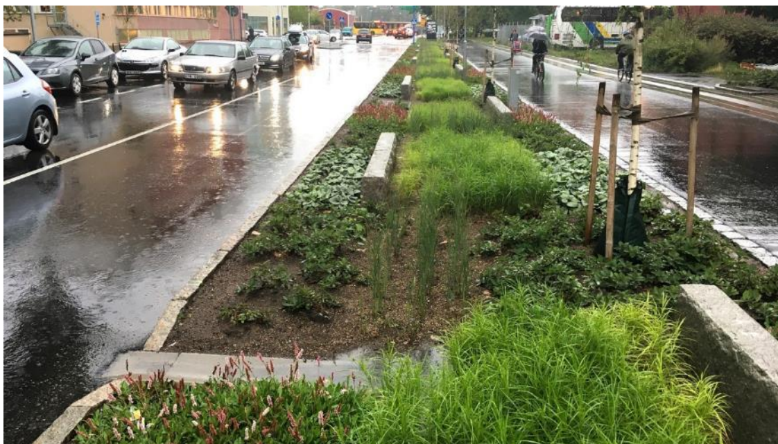
Figur 20. Exempelbild på en nedsänkt växtbädd (Strandbodgatan, Uppsala). Foto: WRS.
