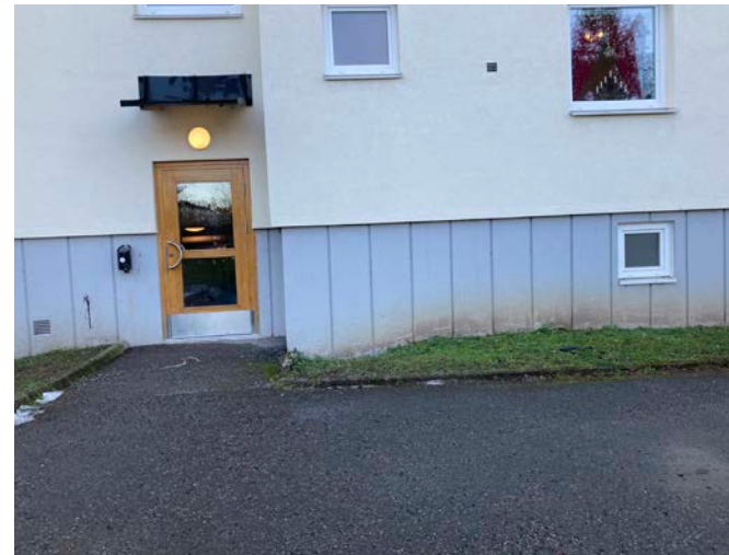
Indragen fasadparti med entrédörr på det västligaste friliggande flerbostadshuset. Sockeln har vertikala spår. Äldre bevarad förgård som ramas in med tidstypisk kantsten.
