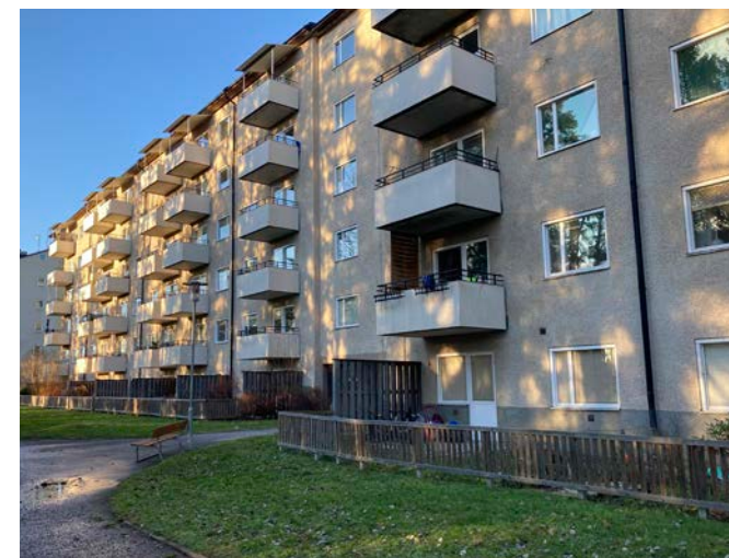
Den södra fasaden med balkonger. Fasaden har en regelbunden uppbyggnad, präglad av repetitionens estetik.
