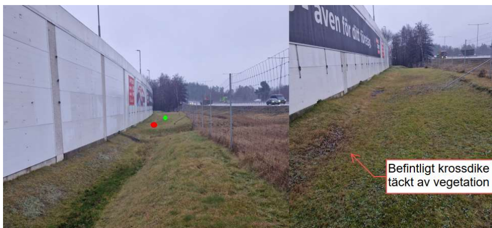
Figur 8. Vänster sida: översiktlig bild på diken längs med den västra fasaden. Röd markering avser ungefärlig startpunkt för krossdike. Grön markering avser ungefärlig position för bild till höger. Höger sida: bild med markering av krossdike täckt av vegetation. Bilder tagna vid platsbesök 2025-01-21.
