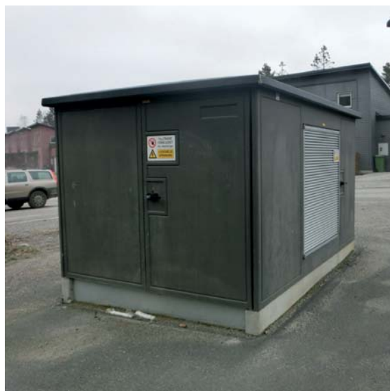
Transformatorstation, Västra Balingsnäs
