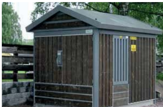
Träpanel transformatorstation från Plåt och teknik
