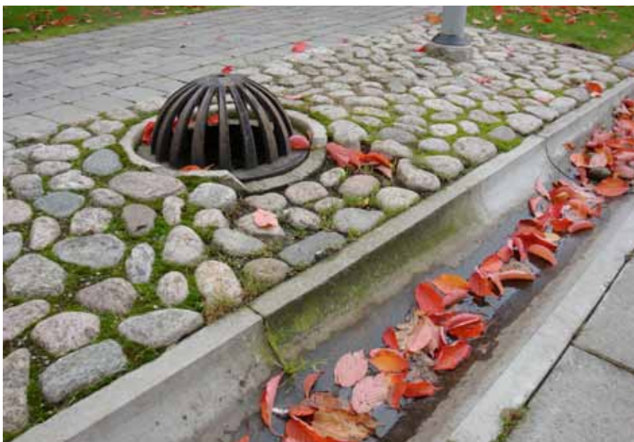
Dagvattenränna. Rännans utformning är viktig för att skapa levande vattenmiljöer. Augustenborg. Foto: Dagvattengruppen Sweco.
