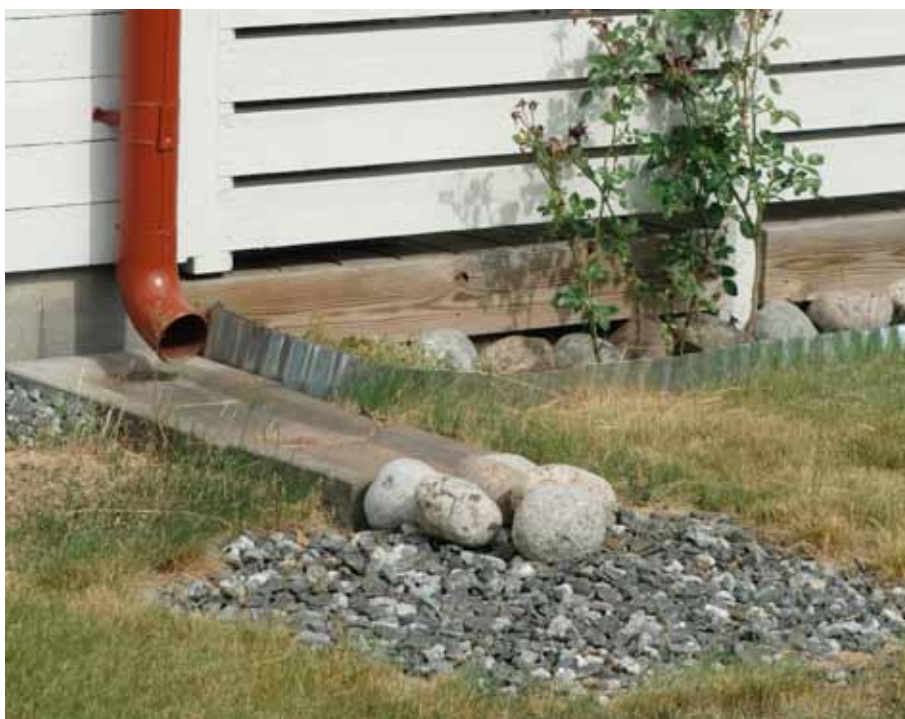
Stuprörsutkastare och rännalsplattor med erosionsskydd som leder ut vattnet på gräsmattan. Stensången Huddinge. Foto: Annika Blomquist.
