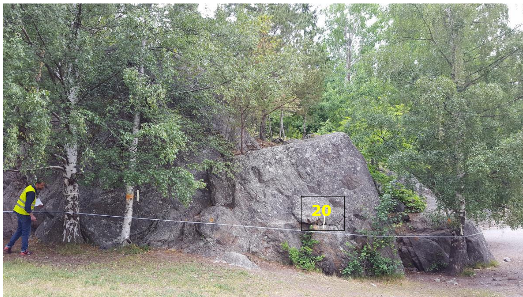
Figur 5 Lm A15-20 Område 1. Ett ca 1 m 2 bomt block med kraftig apertur, förhållandevis fast dock fler synliga sprickor. Rekommenderas att tas bort. Foliationen i området är något svårbedömd vid Lm A17–22. Se Figur 6.
