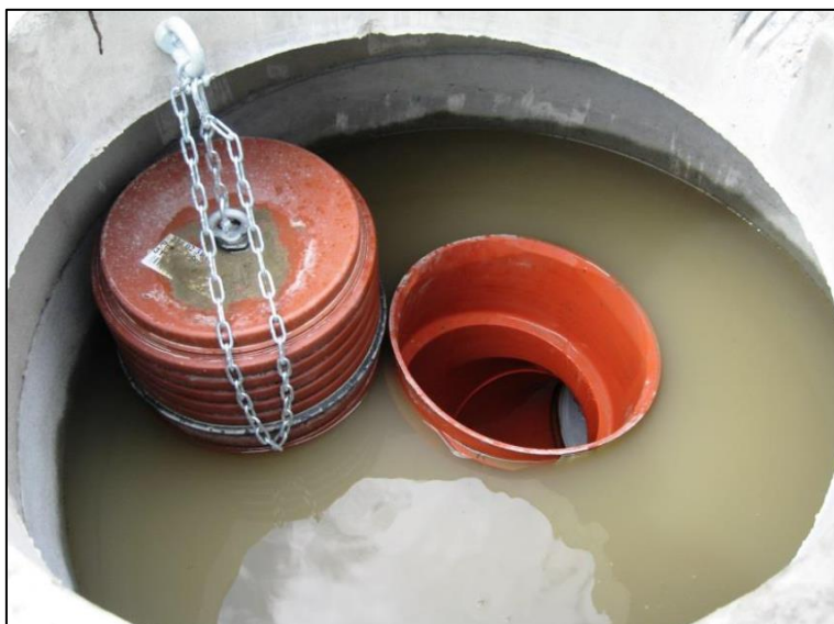
Figur 34. Avstängningsanordning i brunn (Foto: Norconsult).
