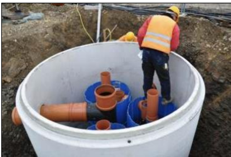
Figur 21. Filterinsatser förlagda i dagvattenbrunn.
