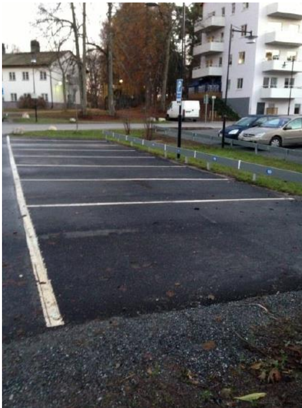
Figur 11. Parkeringsplats anlagd med asfalt. Dagvatten avrinner till grönstråk i mitten av parkeringen då asfaltsytan är lutad så. Lösningen leder till minskad avrinning inom området och rening av dagvatten.
