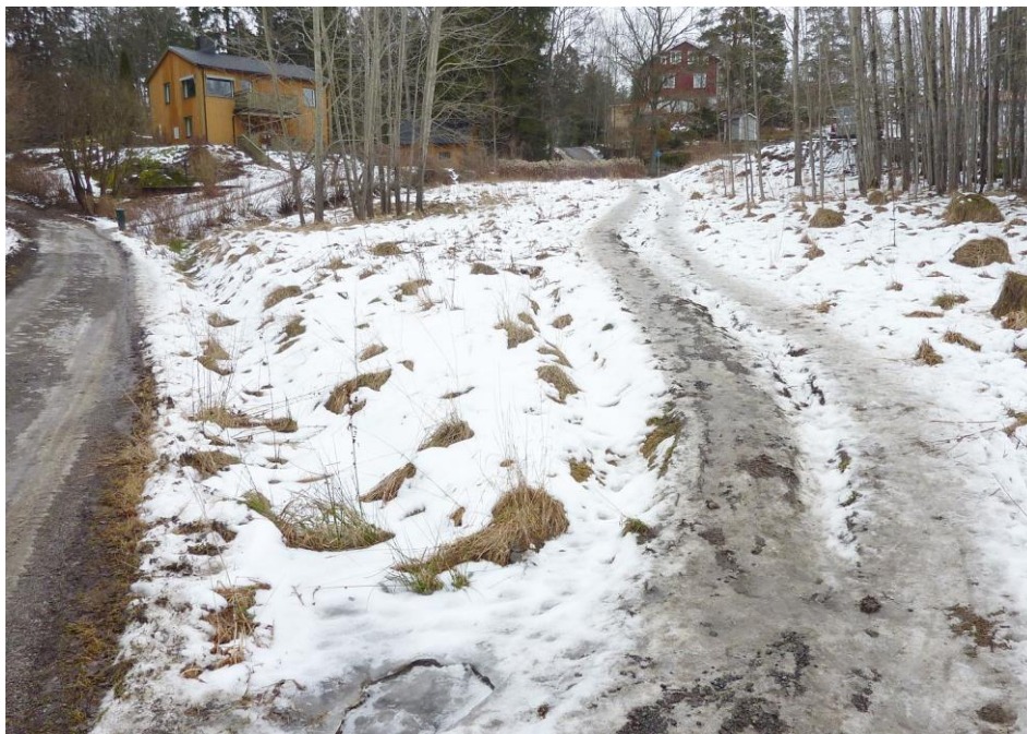
Figur 4. Gångvägen som leder ner mot Gamla Stockholmsvägen från "Säckgatan" fungerar också, oavsiktligt, som dike för avledning av dagvatten.
