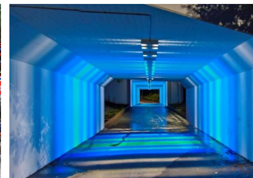
Exempel på belysning i gångtunnel i Huddinge (hållbarstad.se)
