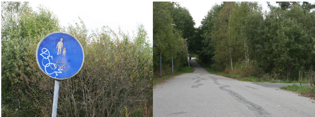
Figur 9: Exempel på dålig drift och underhåll. Utsliten målning och nerklottad skylt samt sprucken beläggning. Foto: Huddinge kommun
