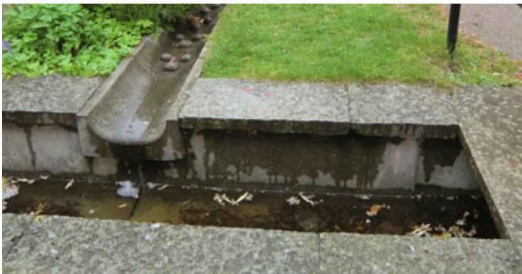
Dagvattenkanal och lökränna, Augustenborg. Foto: Anette Björlin.
