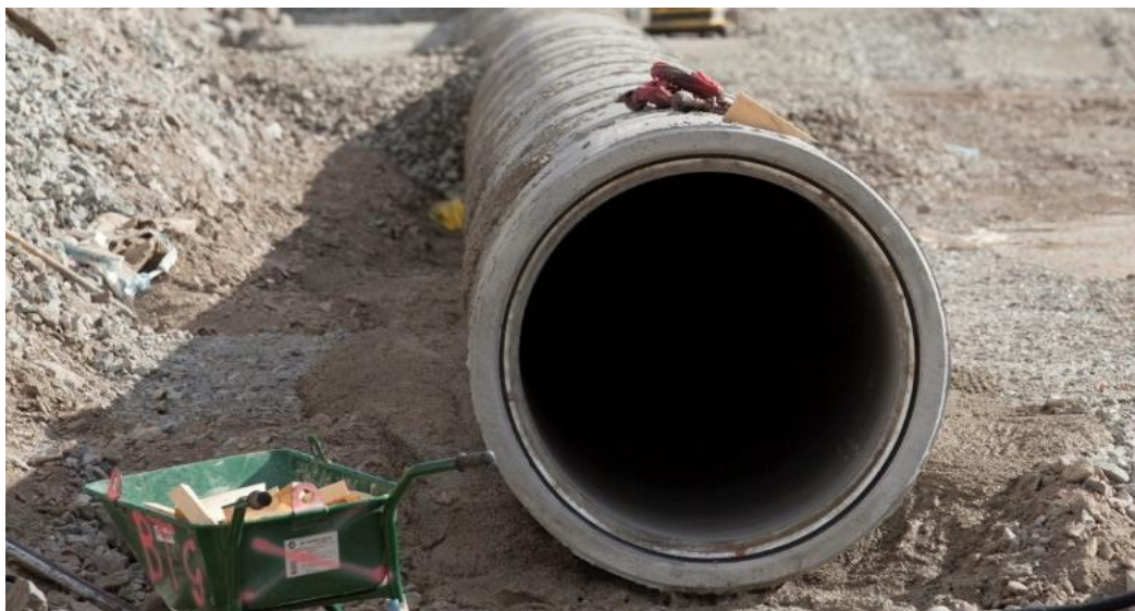
Figur 2. En kulvert som samlar flera ledningar vara effektivt. Foto: Huddinge kommun.
