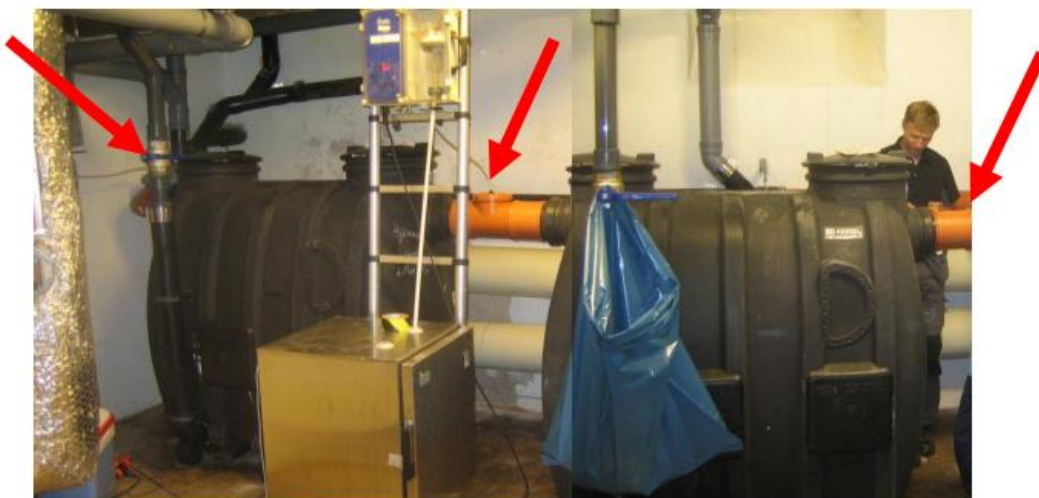
Figur 12 Två sammankopplade fettavskiljare, en för matavfall och en för fettavfall
